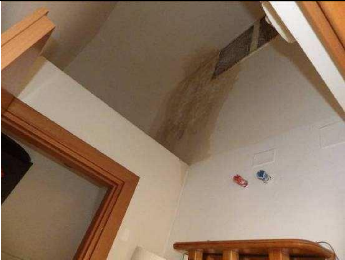
Foto n° 9 - Via Pavoni 56 negozio vista interna infiltrazione bagno
