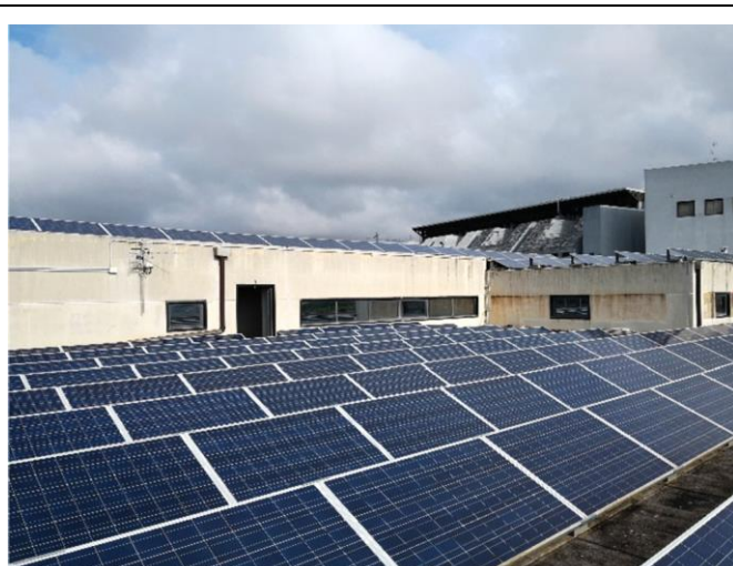
Vista impianto fotovoltaico – copertura piana
