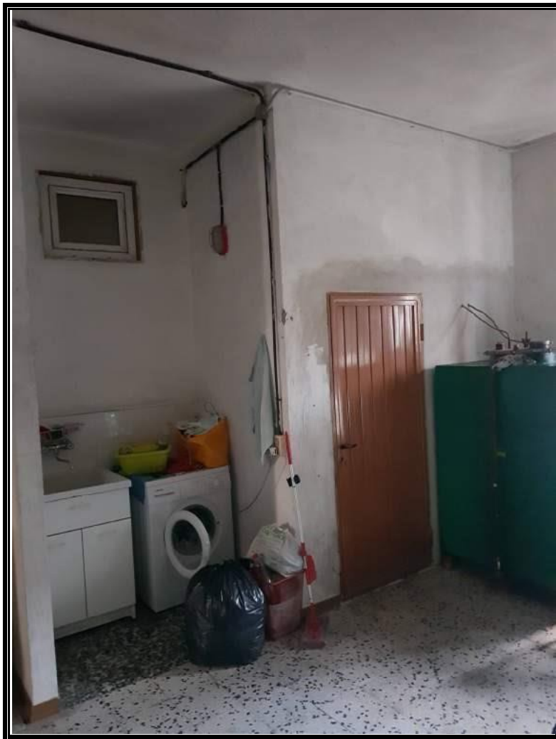
Foto n. 7 – Particolare dell'ingresso della centrale termica (p.lla 99 sub. 25)
