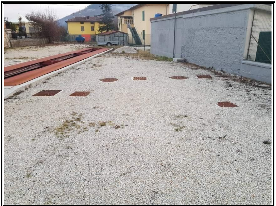
Foto n. 13 –Veduta del sistema di raccolta acque meteoriche ed olii (sulla p.lla 738)
