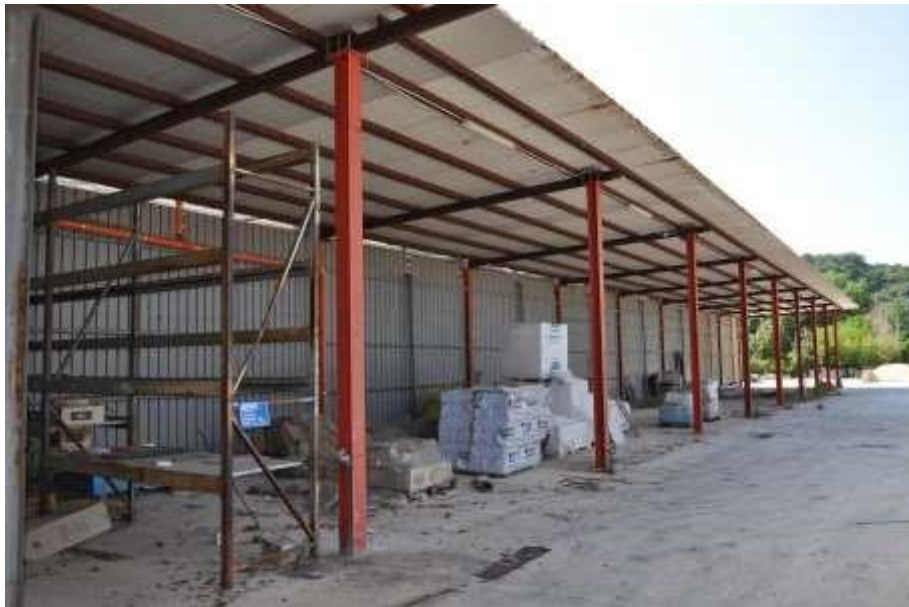
Fotografia n.8 – Altra visuale della porzione porticata “C” realizzata per mezzo di struttura in ferro destinata al deposito dei materiali edilizi.
