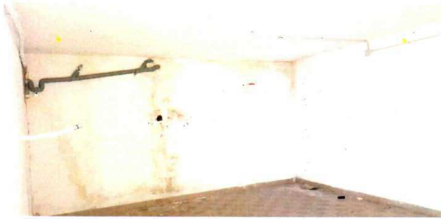
Foto 4 - Infiltrazioni d'acqua nella parete laterale del magazzino
