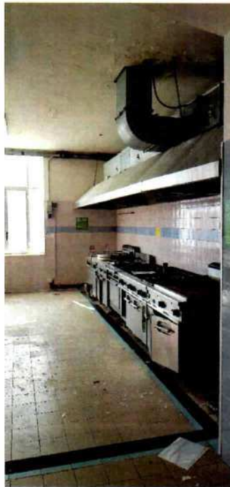
Foto 5 - Infiltrazioni su pareti e soffitto del locale cucina
