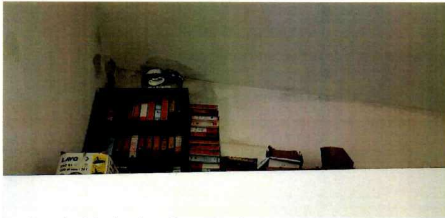
Foto 6 - Macchie da infiltrazioni nel ripostiglio al piano primo
