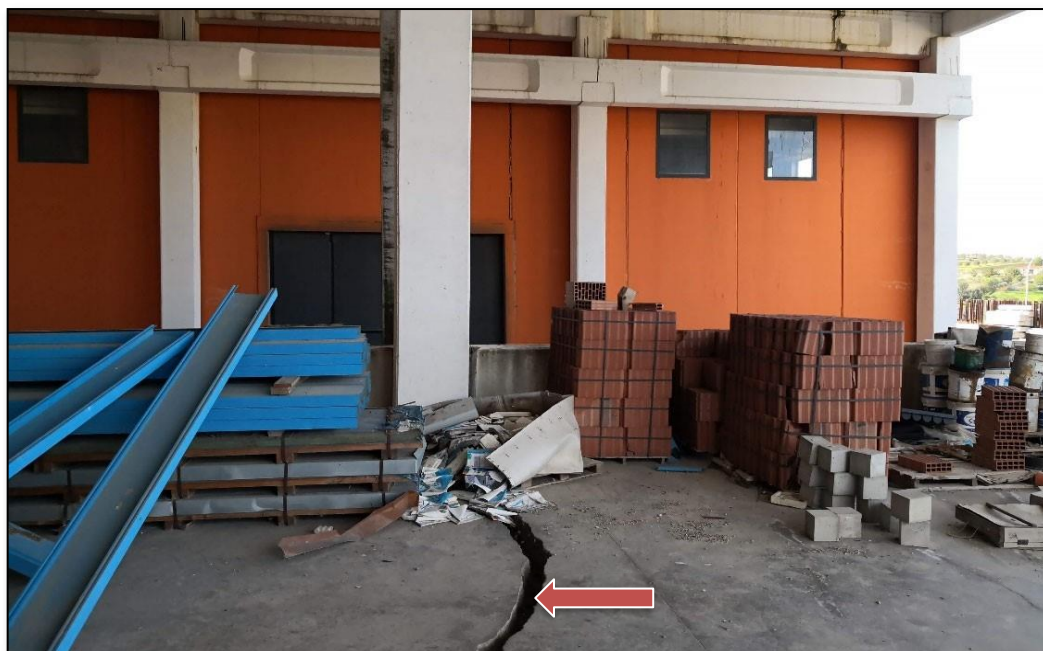
veduta portico – in evidenza lesione pavimentazione
